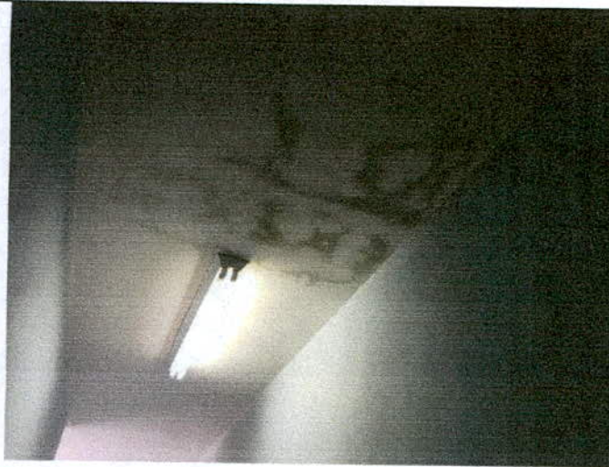
FIGURA 07- Corredor com infiltração
